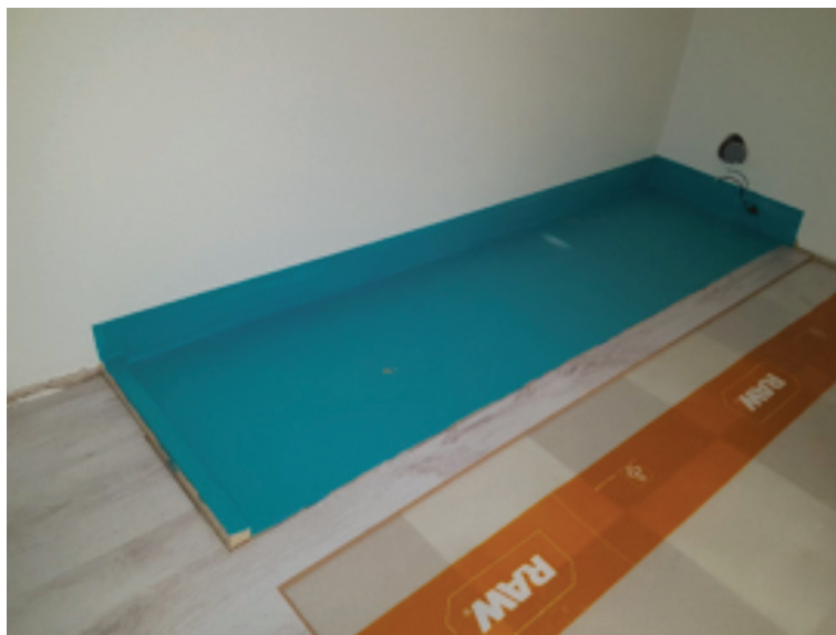
Kuva 1. Keittiön alakaappien alapuolisen lattian korkotasoa tulee olla vähintään yhtä korkealla tulevan keittiön lattian koron kanssa, jotta vuotokaukalo ohjaa veden keittiön lattian pintamateriaalin päälle.
